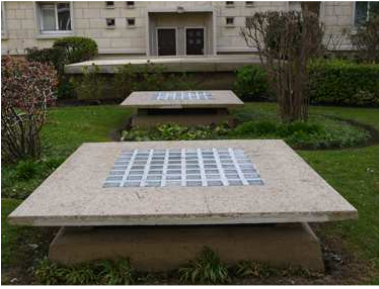
Exemple de puits de lumière sur dalle- Ilot V2 rue de Caligny
